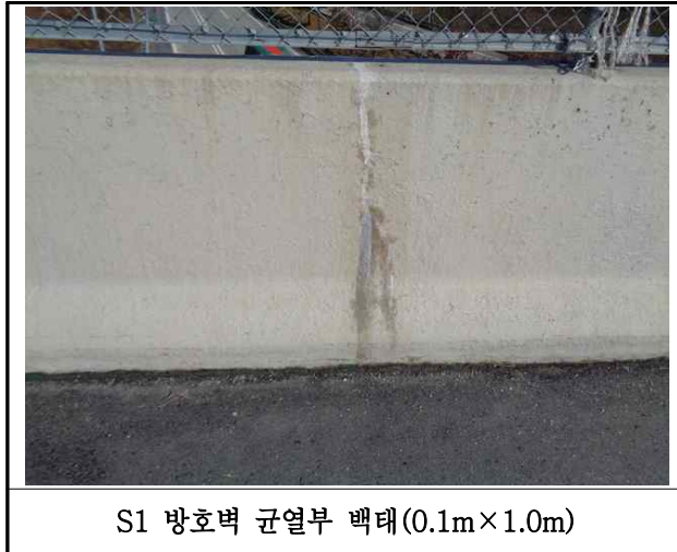
【사진 15.3.21】 방호벽 손상현황
