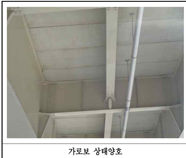
【사진 15.3.7】 가로보 손상현황
